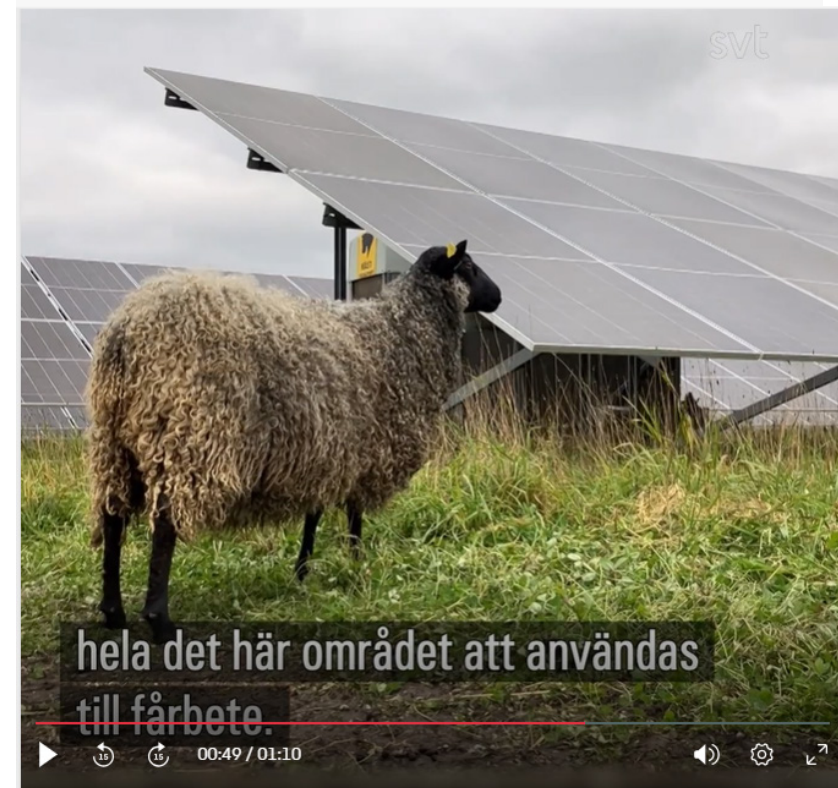
Invid och i drift. Nu produceras el på närmare 22 MW på solcellsanläggningen i Kungsåra. Foto: Rasmus Hammarström/SVT
